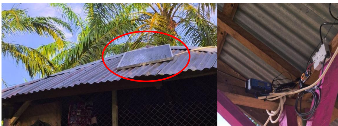
Gambar 4. Dokumentasi Perangkat dan instalasi solar cell
